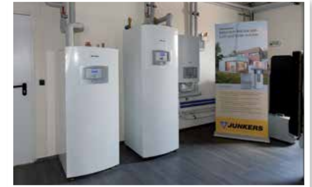
Neueste Technik von Junkers zum Anfassen: Jede Anlage kann den Erlebnis-Raum beheizen.
