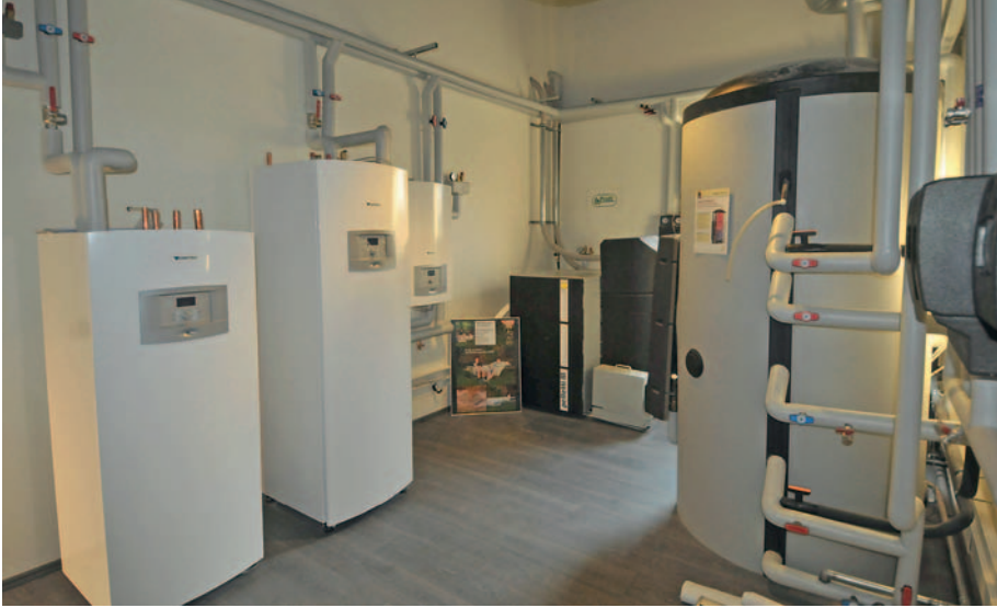
Wärme-Erlebnis-Raum. Kunden können hier u.a. verschiedene Arten der Wärmeerzeugung sowie passive Kühlung live erleben und spüren.
